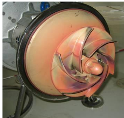
Εικόνα 1. Σχηματισμός ερύθρωσης σε επιφάνειες ανοξειδωτου χάλυβα EN 1.4404 / AISI 316L σε εφαρμογή W.F.I. (Αριστ. Φωτ. Σωλήνωση / Δεξιά φωτ. αντλία ανακυκλοφορίας)
